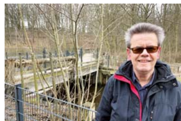
Wolfgang Kühl, CDU-Mitglied im Regionalausschuss Alstertal an der sanierungsbedürftigen Mellingburger Schleuse. Bildquelle: Wolfgang Kühl/CDU Alstertal
